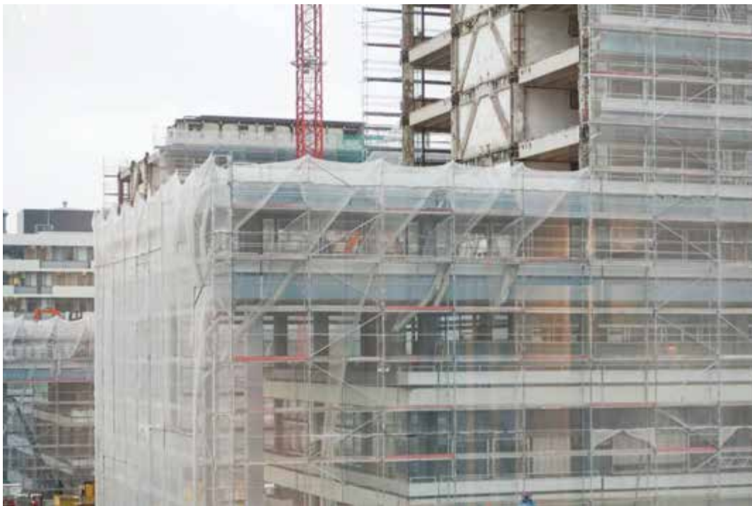
Bild 4.41: Abriss des Gebäudes IA im Januar 2015, man erkennt noch oben links den Raum, in dem unser Kriechlabor war. Fig. 4.41: Demolition of the old building IA. The room that housed our creep laboratory can still be seen on the upper left, January 2015.
